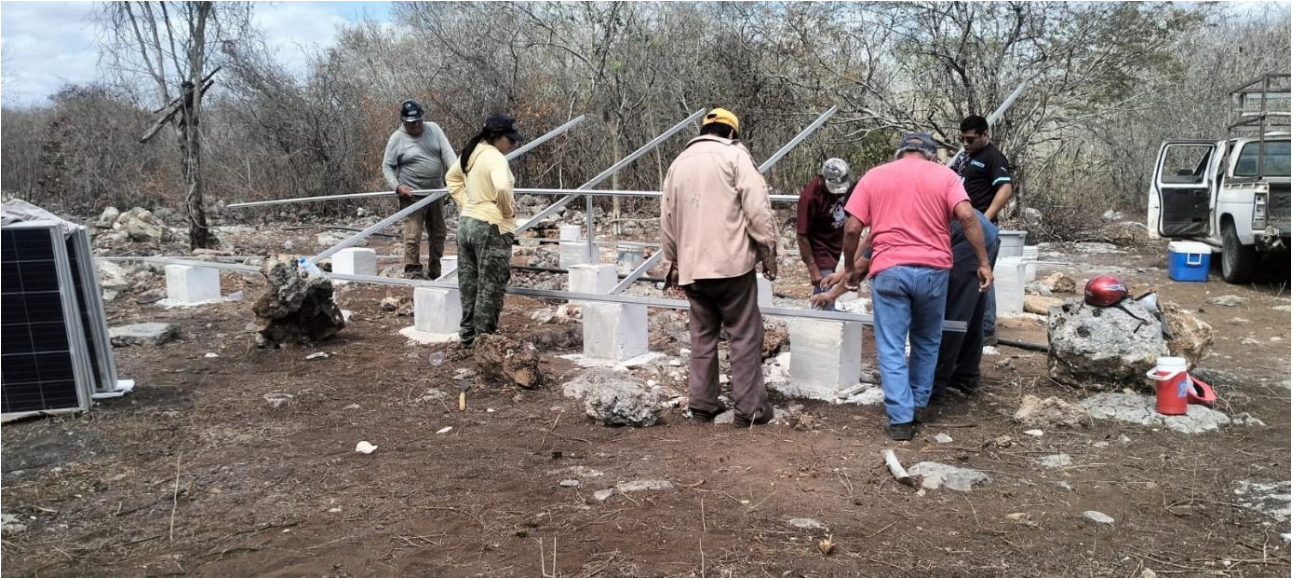
Ilustración 6 - verificación de bases de aluminio incompletas
